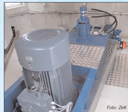
Die Restwassermaschine im KW Geyerwehr
