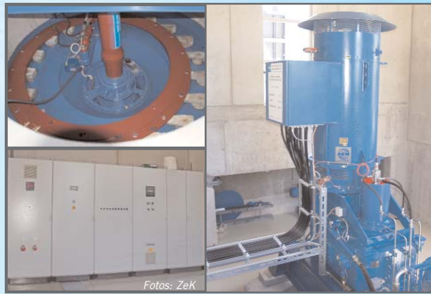
Links unten: Steuerungsanlage (Schubert) und die maschinelle Ausrüstung
