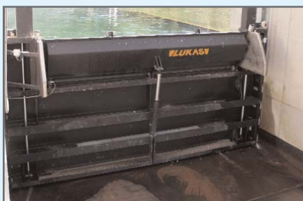
Grundablass von der Firma LUKAS. Foto: ZeK
