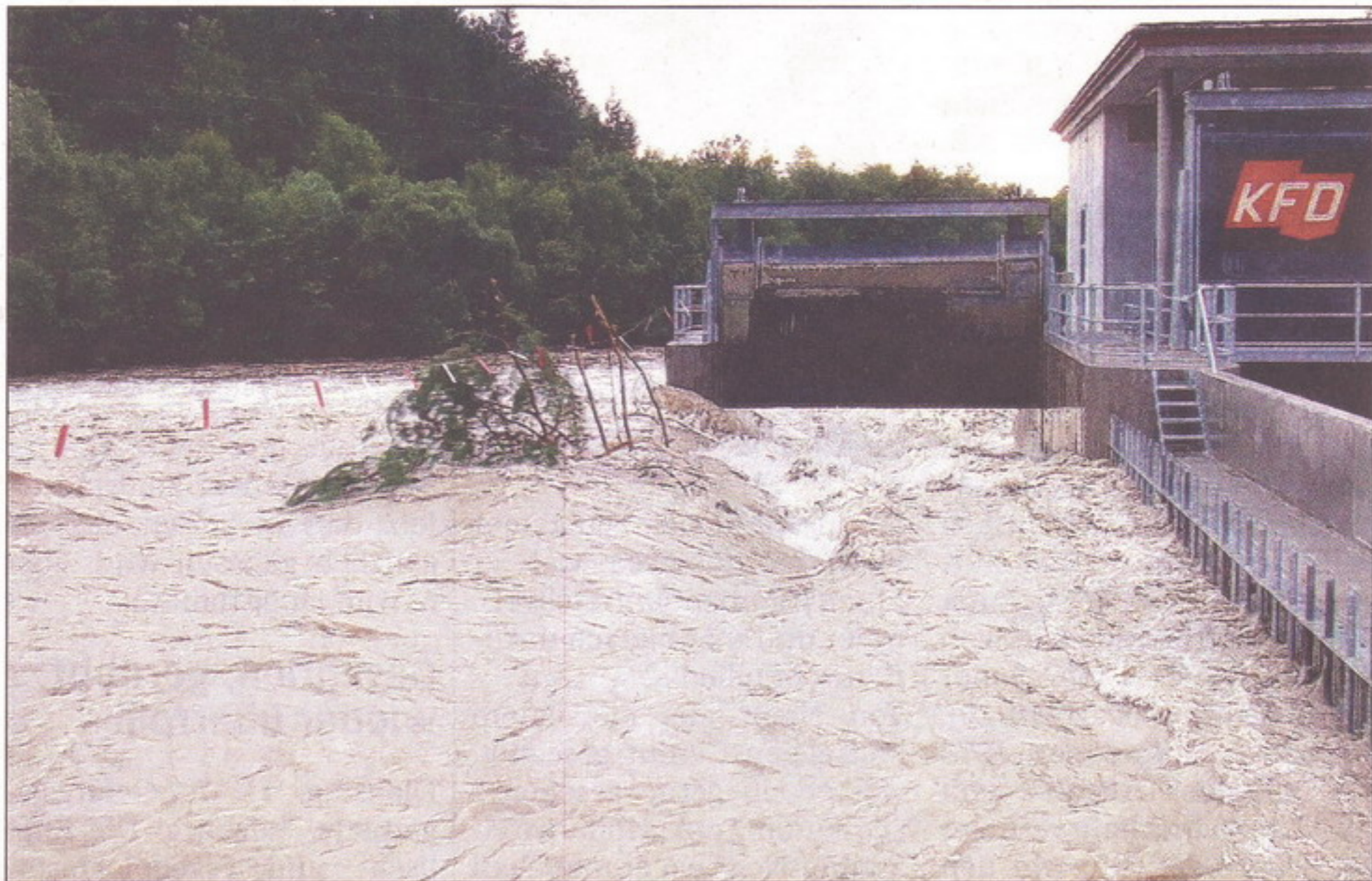
Auch Baumstämme konnten dem neuen Kraftwerk nichts anhaben.
