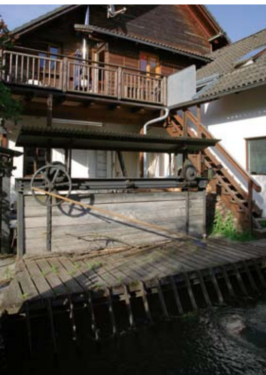
Grobrechen beim Turbineneinlauf
