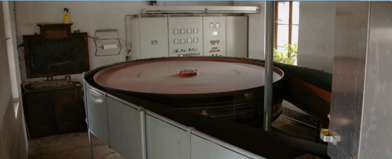
Horizontaler Riemetrieb im Kraftwerk Scharnstein
