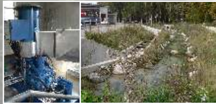
Abbildung: Maschinensatz: Synchron-generator mit Getriebe (links), Fischaufstiegshilfe "Vertical-Slot" und Reifenmühlbach (rechts)
