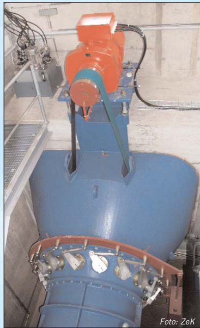
Kaplan-Rohrturbine im Maschinenhaus
